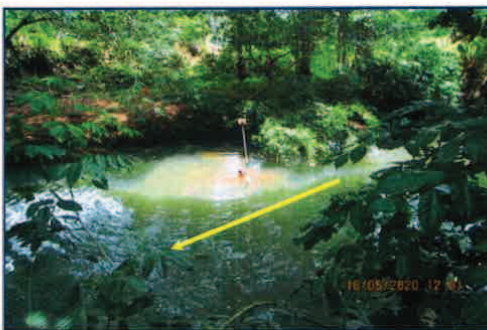
Foto 6. Equipo de Topografía JACUM ejecutando el levantamiento de las secciones transversales de la Quebrada Grande. Fuente: JACUM, mayo de 2020.
